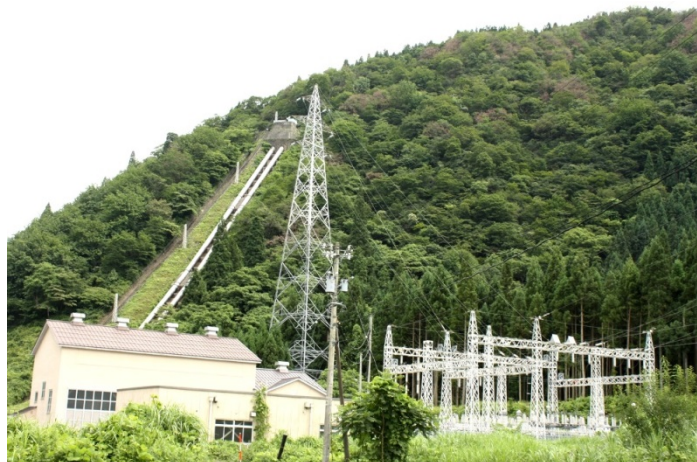
片貝第二発電所 全景
