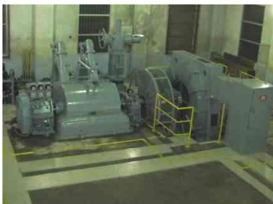
2号水車・発電機
