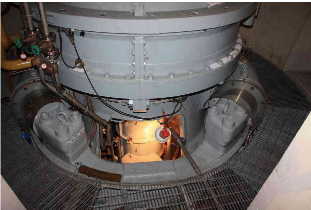
神通川第二発電所 水車
