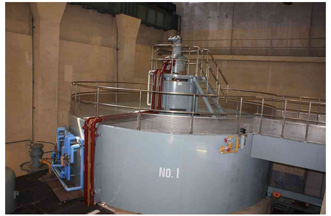
神通川第二発電所 発電機
