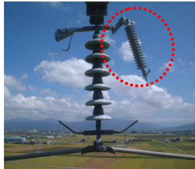
雷害対策 (送電用避雷装置)
