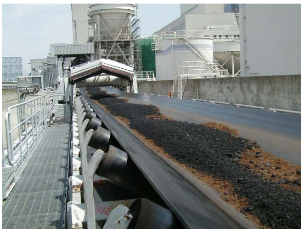
◆H16木質バイオマス混焼試験 燃料(石炭+木質バイオマス)搬送状況
