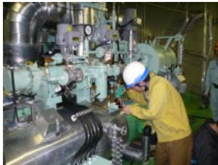
◆志賀原子力発電所2号機 竣工検査の一例（冷凍機漏えい検査）
