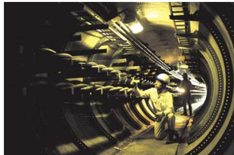
◆地中電力ケーブルの点検
