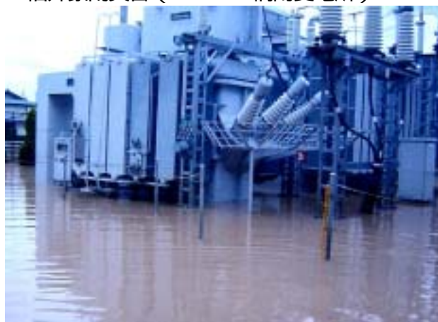
福井豪雨災害 (H16/7 橋南変電所)
