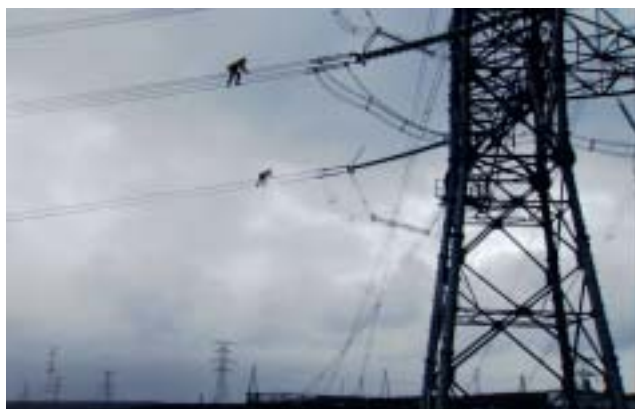
<H17/6 使用開始 500 kV 2回線 69 km>
