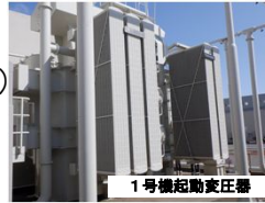
1号機起動変圧器
