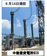
中能登変電所GIS
