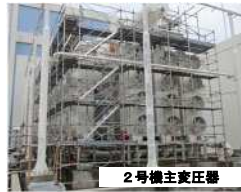
2号機主変圧器
