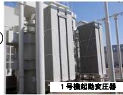
1号機起動変圧器
