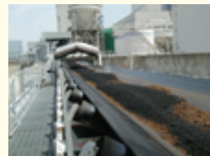
敦賀火力発電所での木質バイオマス混合燃料(石炭・木質バイオマス)の搬送
