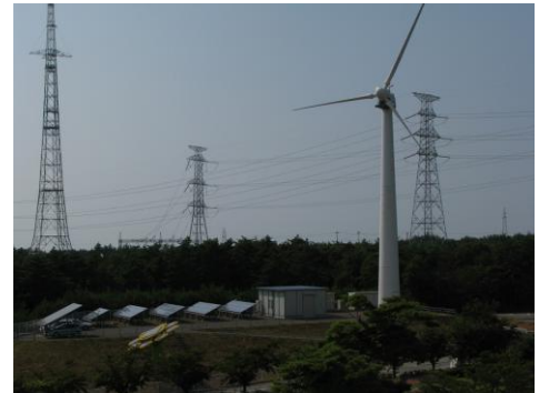
写真1 志賀風力・太陽光発電センター
