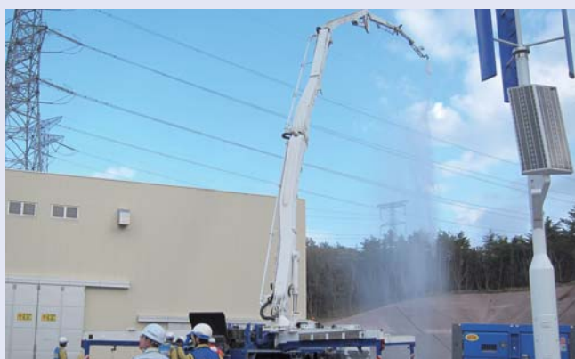
高所注水車の操作訓練 常設の配管による使用済燃料貯蔵プールへの注水やスプレイができない場合に用いる高所注水車からの放水訓練
