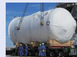
格納容器フィルタ付ベント装置の設置
