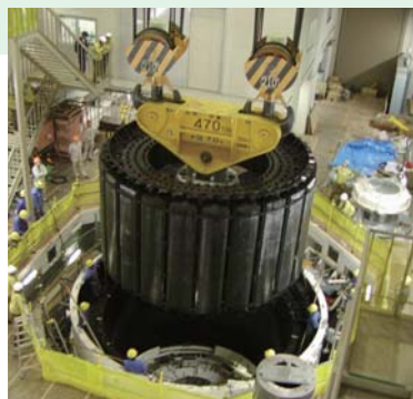
有峰第一発電所 前回オーバーホール
