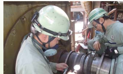
富山火力4号機定期点検の様子(北陸発電工事)
