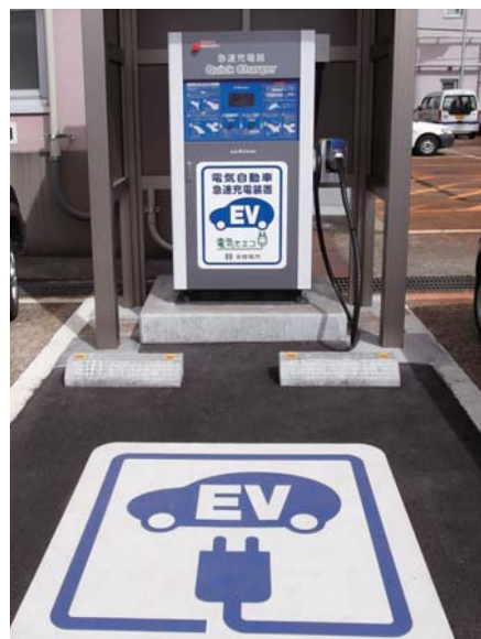
急速充電装置(小松支社)
