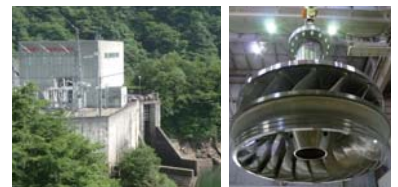
有峰第二発電所 全景
